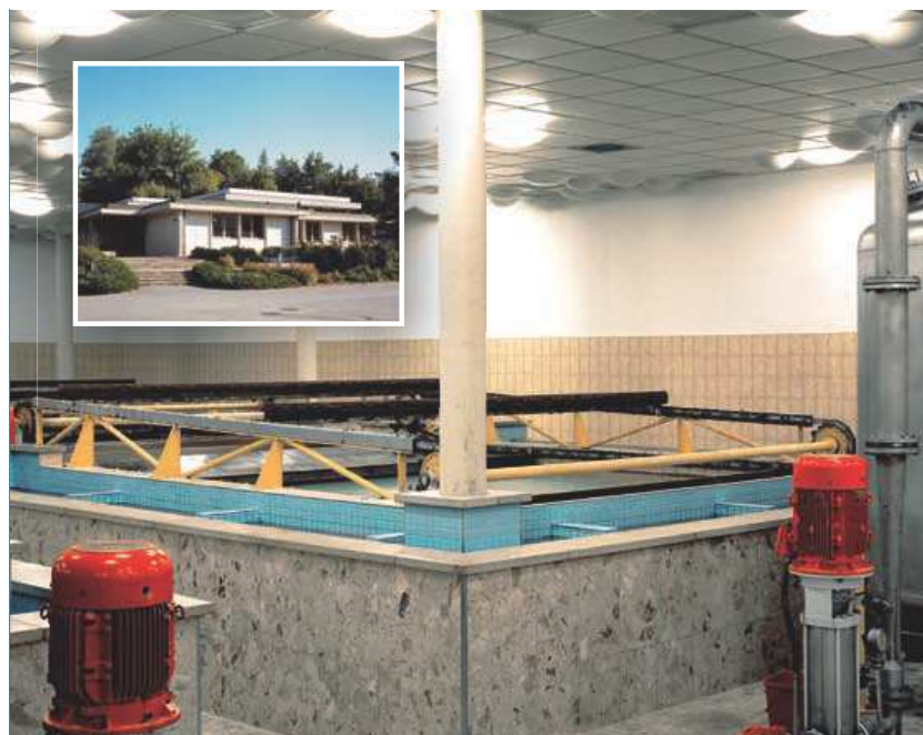
Usine de traitement de l'eau de Saint-Sulpice
