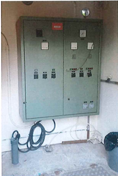
Extérieur du tableau de commandes
