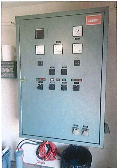
Extérieur du tableau de commandes
