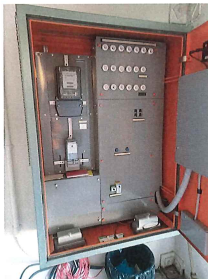
Intérieur du tableau de commandes
