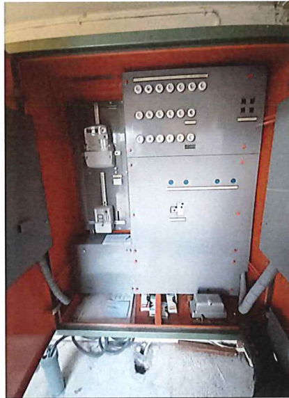
Intérieur du tableau de commandes
