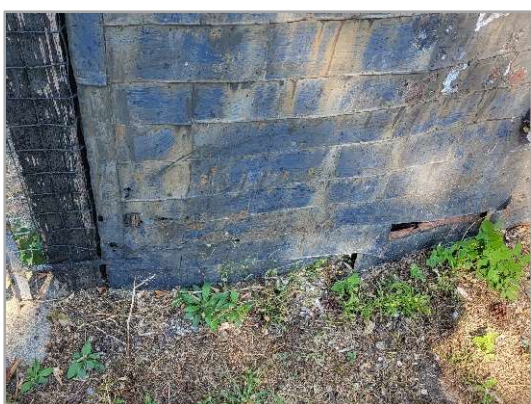
Tôles de façade rongées par la rouille
