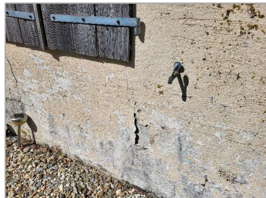
Etat du crépi et des volets, présence de lichens
