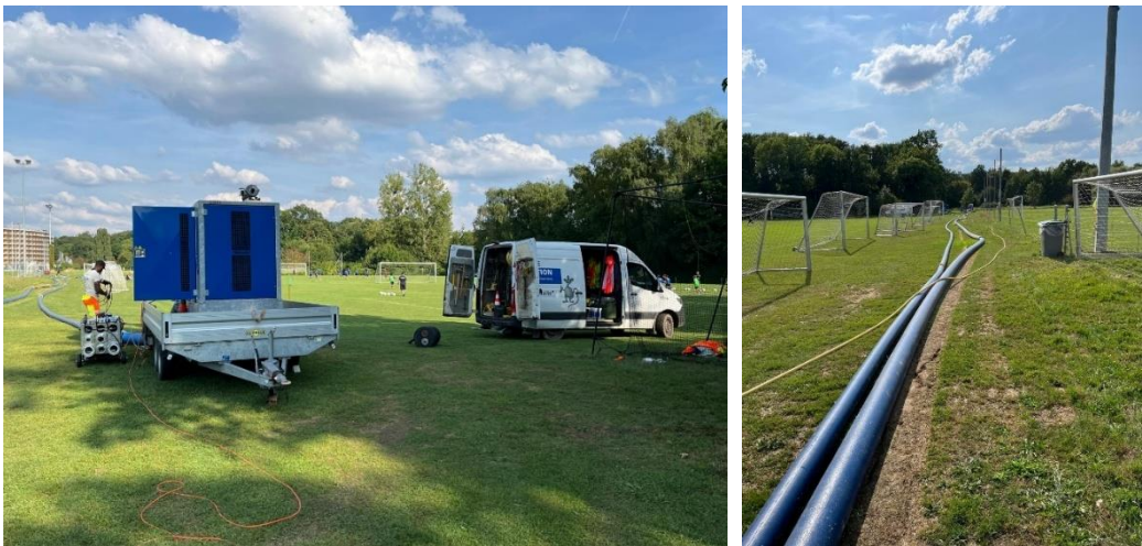
Installation provisoire de pompage pour le gainage du collecteur du secteur 15
