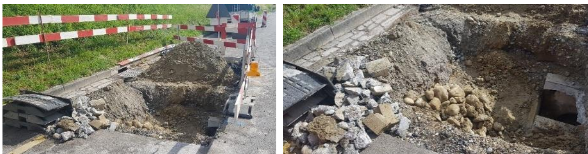
Affaissement juin 2025 et réparation juillet 2025
