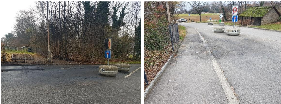
Constat des dégâts occasionnés sur le domaine public du chemin du Laviau
