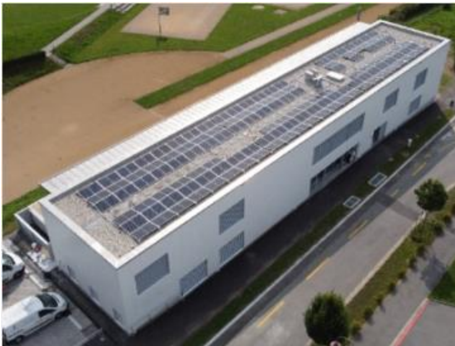
Exemple de suivi de la production énergétique : la production d'électricité des panneaux photovoltaïques installés sur le toit de la garderie
