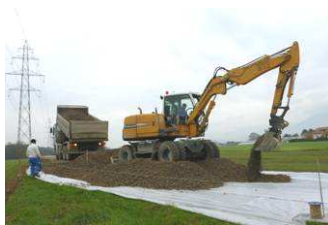
Mise en place d'une piste provisoire sur un géotextile, sans circulation sur le sol en place
