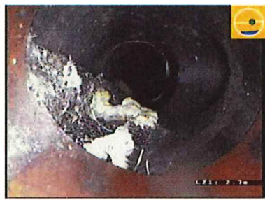
Joint non étanche (exemple du collecteur - chemin du Bois)
