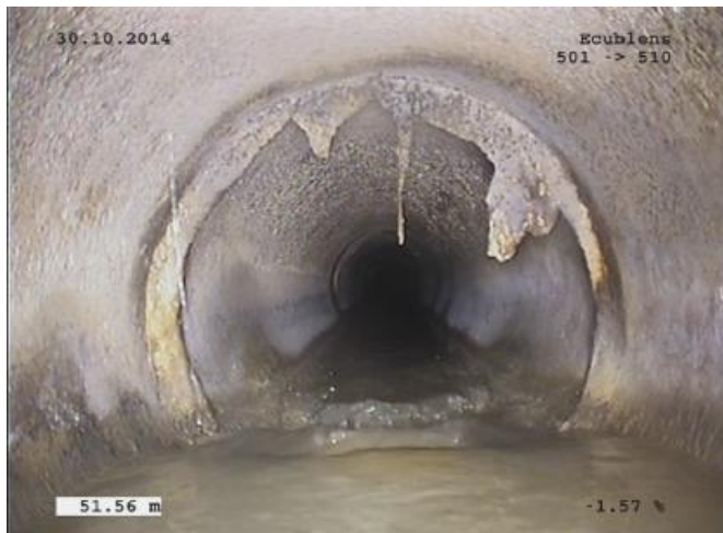
Calcaire aux joints et dépôts sur le radier
