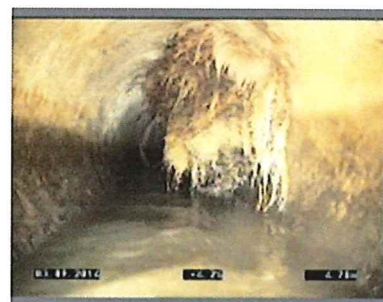
4. Perforation avec importante pénétration de racines
