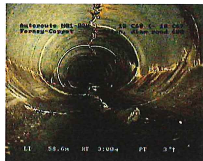
2. Fissuration, ovalisation du collecteur
