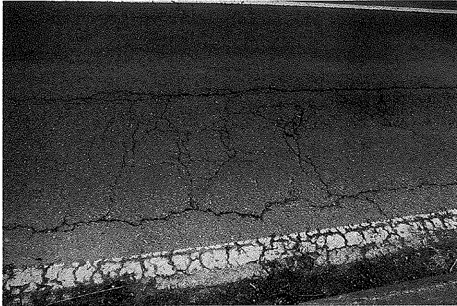
Figure 5 : état de la chaussée
