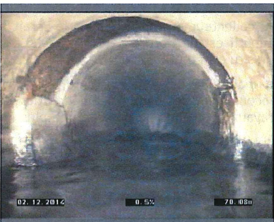
Rhabillage par plaque métallique du collecteur, défaut d'étanchéité.
