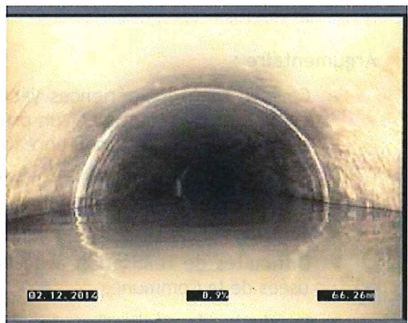
Collecteur lors de sa mise en charge, l'écoulement reste effectif.
